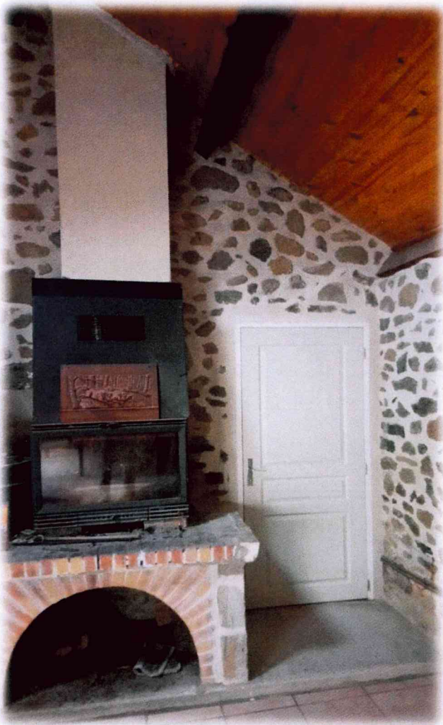
Création d'une porte de communication Local des chasseurs / Cuisine Pour un coût de 2953,50 € TTC
